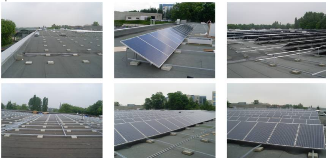
Figure 2 : Capteurs solaires PV montés sur une structure métallique maintenue en place par du lestage. (Projet D'Ieteren)
