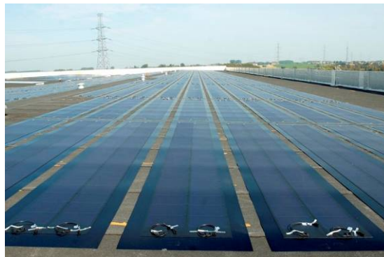
Figure 4 : système constitué de modules au silicium amorphe collés sur la membrane d'étanchéité de la toiture. Projet Colruyt, Halle. [Photo Colruyt].
